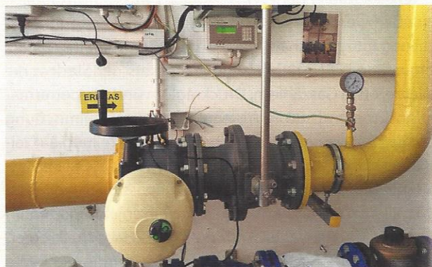
Erdbebenschutz für Gasanlagen
